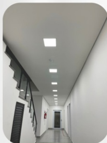
Forro em Drywall
